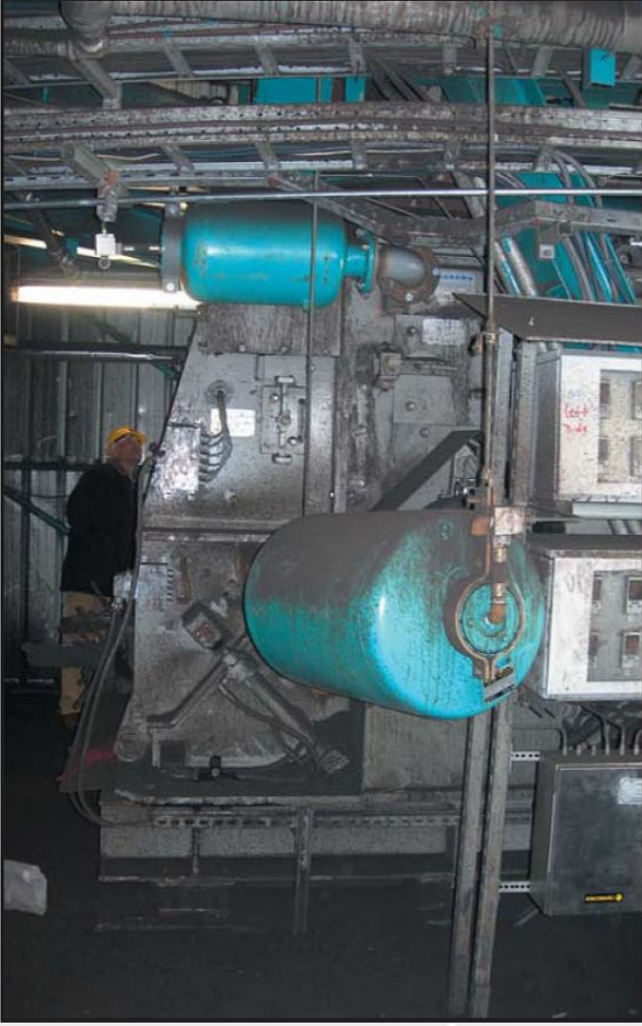
KIRICI YÜZEYİ TERMİK SANTRAL
